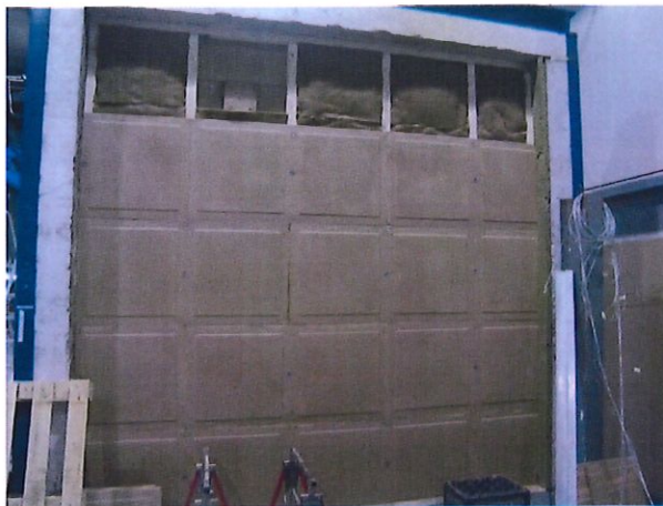
Bild A5.5: Einsetzen der Gefachdämmung d = 60 mm dicke Jutedämmung und Bekleidung der Wandseite B mit d = 22 mm dicker Lehm-bau-platte LEMIX 2.0.
