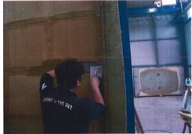
Bild A5.4: Befestigung der Lehm-bau-platten mit Schnell-bauschrauben \varnothing 3,9 x 45 mm inklusive Halte-teller HV 36 sowie Verspachtelung der Platten-fugen mit „Agaton Lehm Oberputz“ und Gewe-beein-lage (Gewebestreifen).
