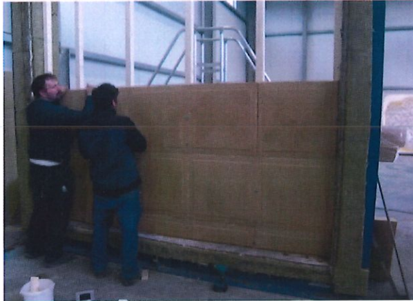
Bild A5.3: Montage der feuerseitigen Bekleidungs-lage bestehend aus d = 22 mm dicker Lehm-bau-platte LEMIX 2.0.
