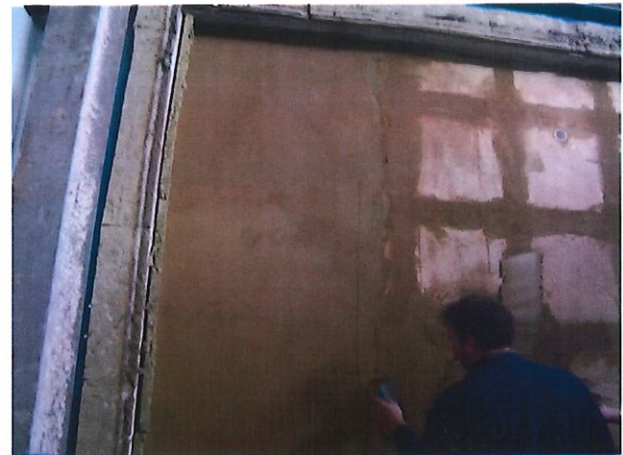
Bild A5.6: Putzauftrag Unterputz „AGATON Lehm Oberputz“ Lehmputzmörtel mit Gewe-beein-lage Glasfasergewebe MAXIT PS 4 mm x 4 mm.
